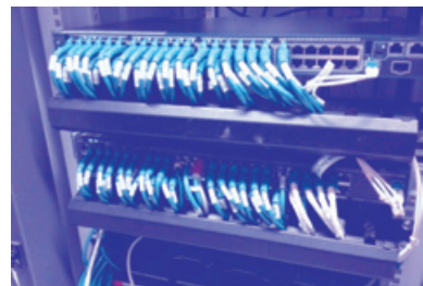
ตัวอย่าง Switch และการเชื่อมต่อสาย UTP ►
